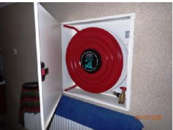
Autoservis 1.16 na I.NP – požiarny vodovod
