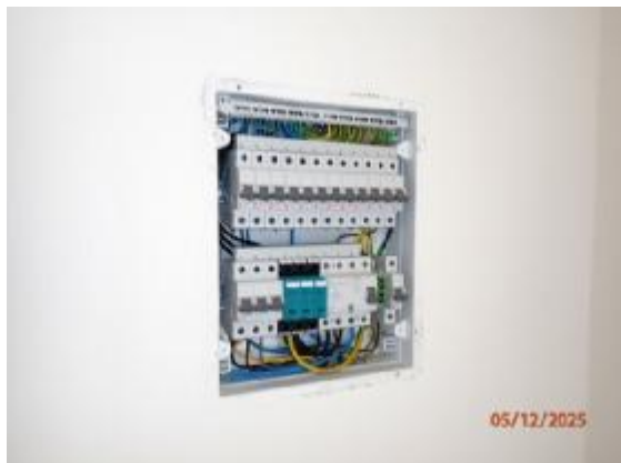
Rozvádzač v miestnosti 1.01 prístavby
