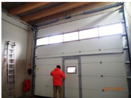
Automatická brána do autoservisu
