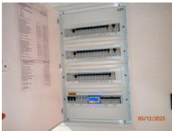
Rozvádzač ELI v Sklade náradia
