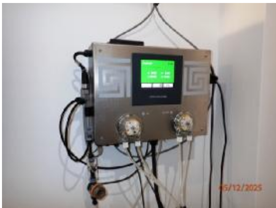
Bazénová technológia v kotolni 1.13
