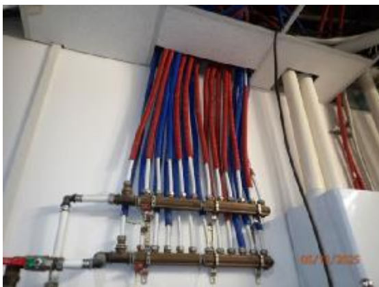
Rozvádzač ÚK v kotolni 1.13
