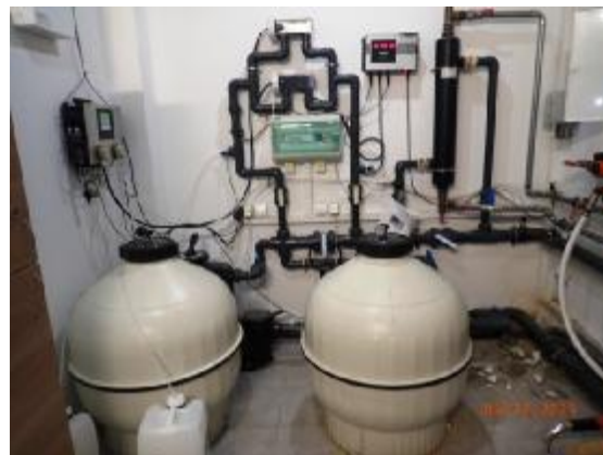
Bazénová technológia v kotolni 1.13
