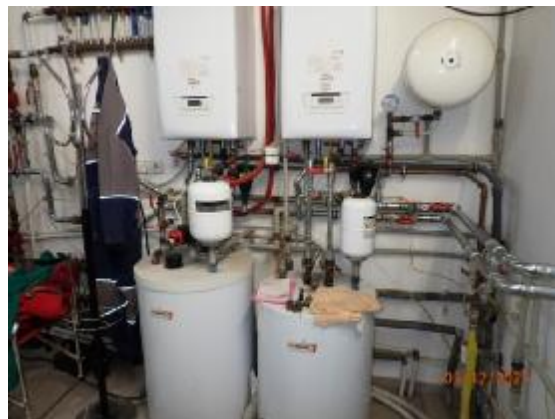
Kotly ÚK na plyn a zásobníky TUV 1.13
