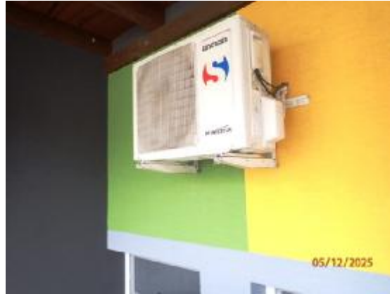
Vonkajšia jednotka klimatizácie
