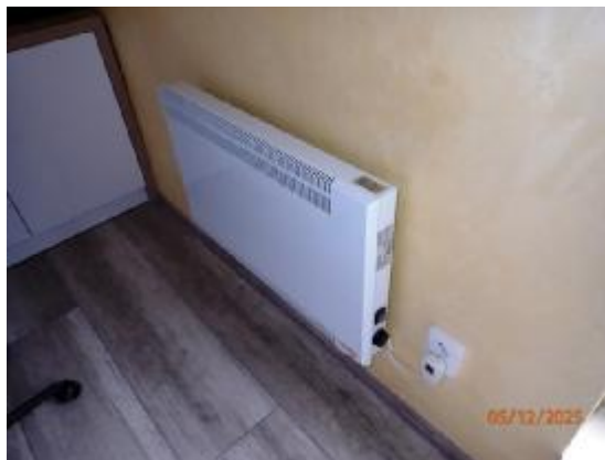
EI. konvektory ako doplnkové kúrenie stavby
