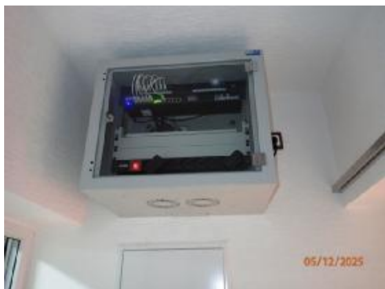
Rozvádzač RACK v Sklade náradia
