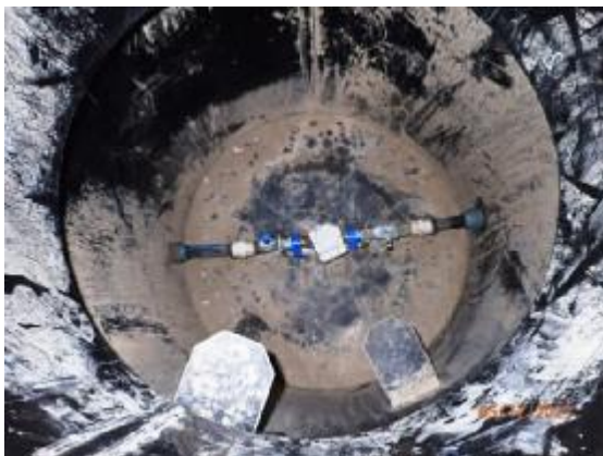
Pohľad do vodomernej šachty
