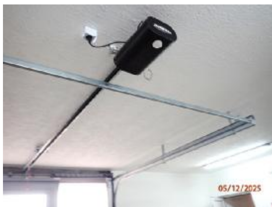
Automatická brána skladu náradia
