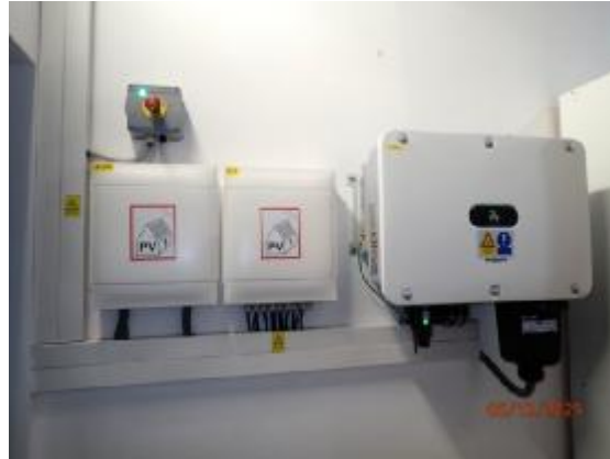
Usmerňovač fotovoltaických panelov
