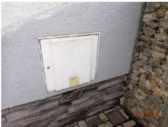
Plynomer na fasáde budovy
