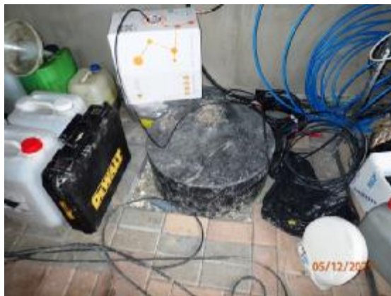
Vodomerná šachta pod vonkajším schodiskom
