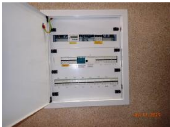
Rozvádzač v autoservise 1.16
