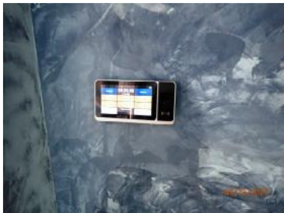
Dochádzkový systém v budove
